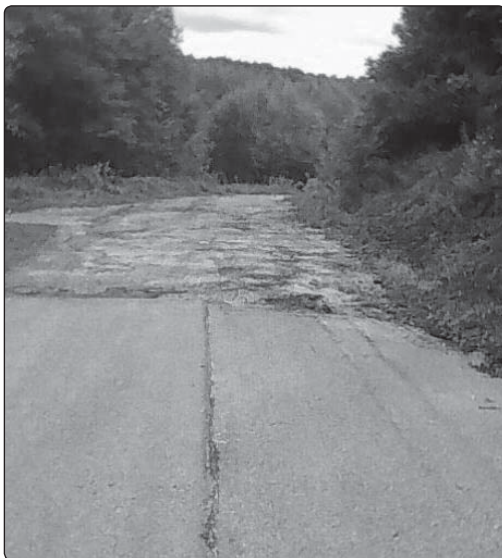
Il. 21. Chrząstowice – droga przez wieś, stan obecny (wrzesień 2021 r.). Za ostatnim domem Chrząstowic kończy się remontowany asfalt, dalej w stronę rzeki i torów kolejowych, gdzie był opisany drugi przejazd kolejowy biegnie od pół wieku nie remontowany asfalt. Widok w stronę Olkusza
